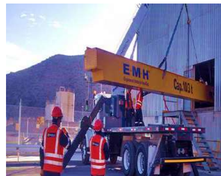
GRÚA PUENTE CAP 10 TON MINERA MILPO CERRO LINDO
