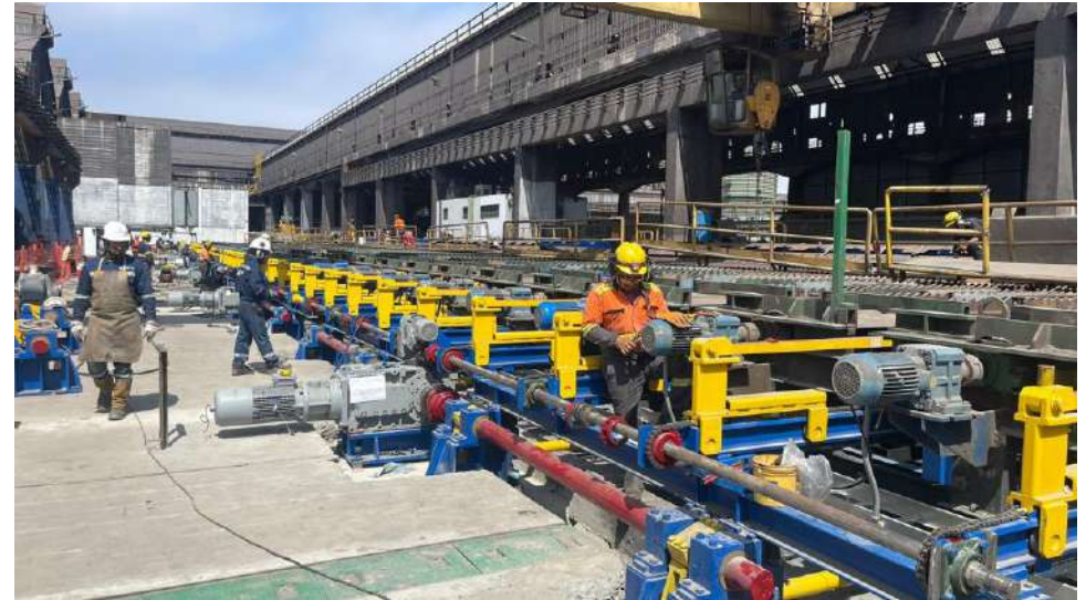
MONTAJE DE MESA DE TRANSFERIDOR DE BARRAS
